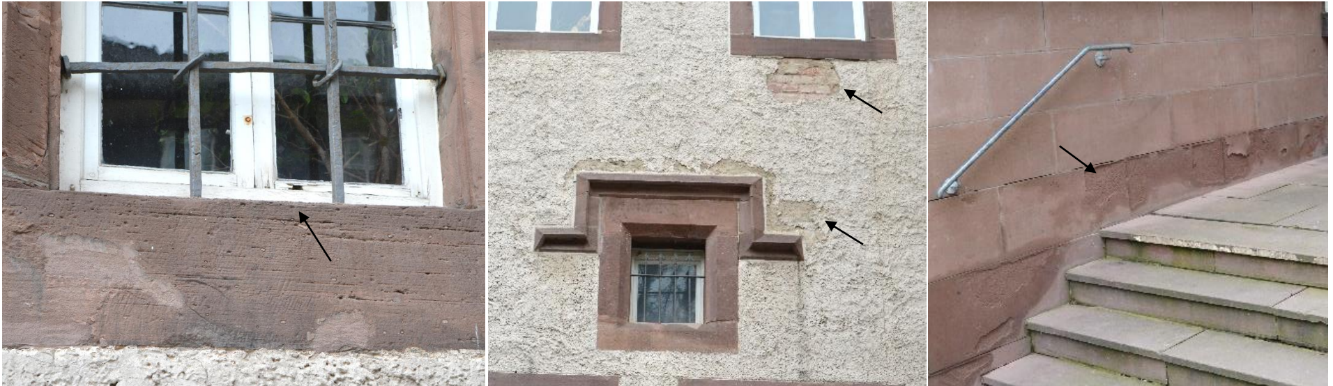
Schäden an Fassaden und Fenstern
