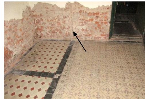
Fehlstellen beim Innenputz
